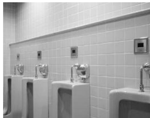
洗浄液装置の付いた便器
